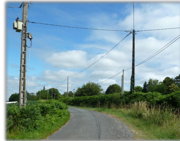
Réseaux aériens à l'entrée sud des Bregères
